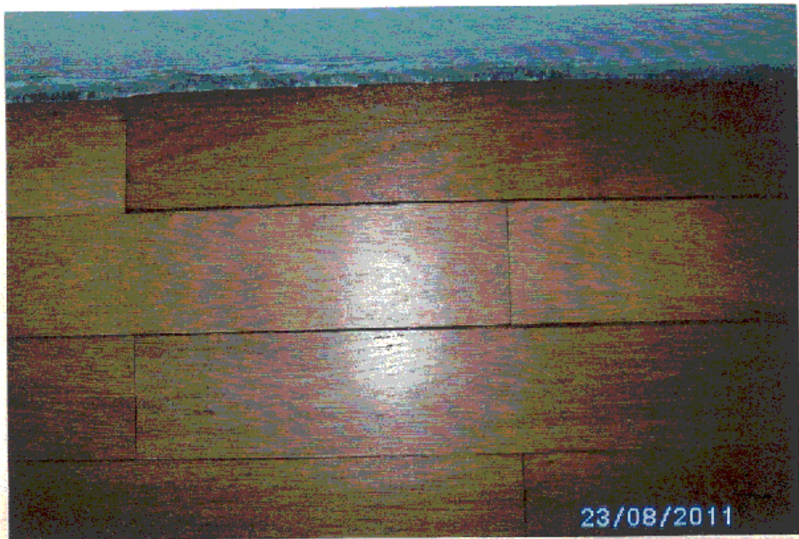
Bild 9 Parkettboden im Kinderzimmer mit der hier offenen Randfuge (fehlende Sockelleisten sowie mit einer Fuge mit Breite über 2 mm (Breite 2,2 mm, Länge ca. 1,5 m)
