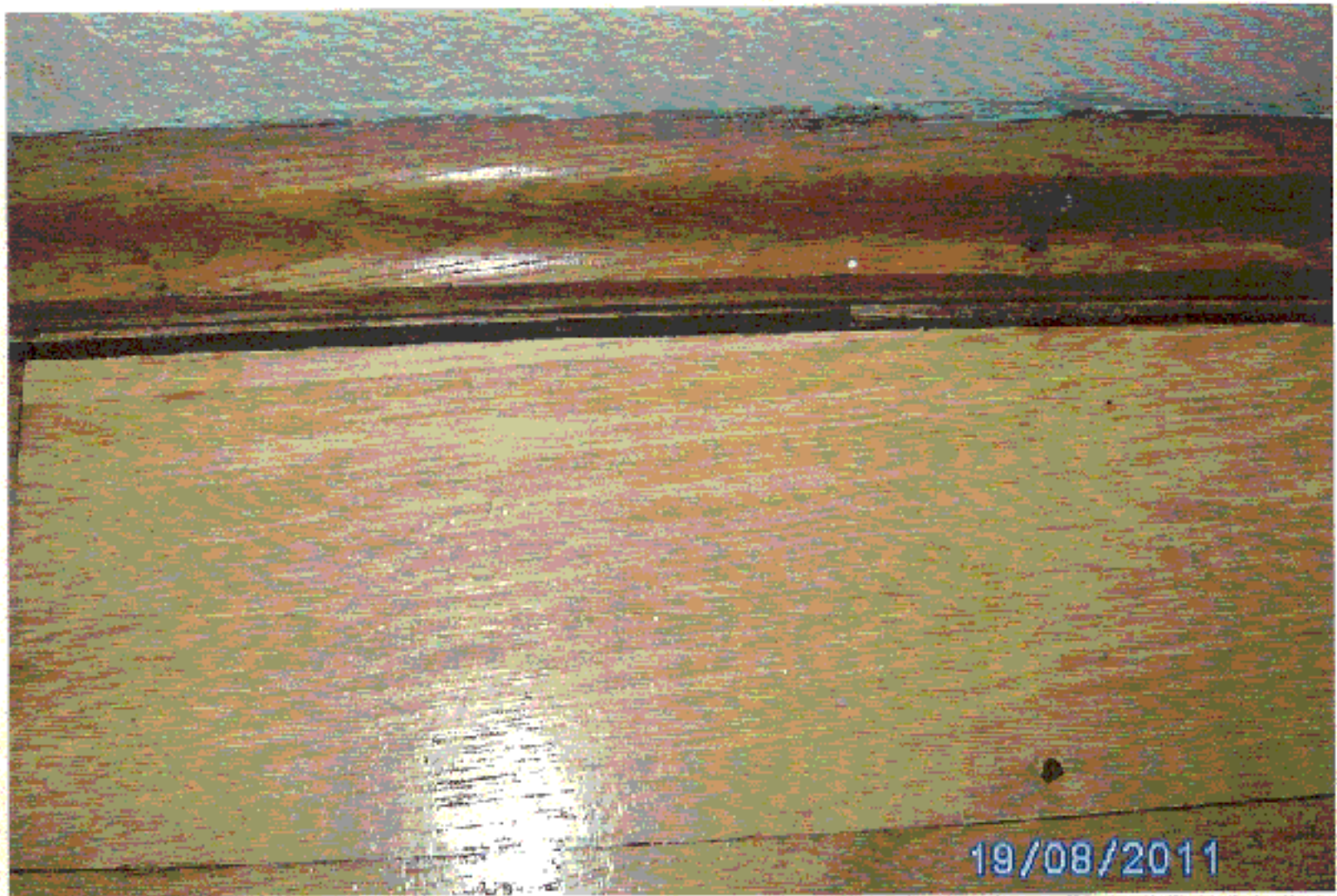
Bild 7 Breite Fuge (Breite ca. 1,0 bis 3,5 mm, Länge ca. 0,7 m,) entlang eines Abschnitts der Sockelleiste an der Ostwand im Schlafzimmer
