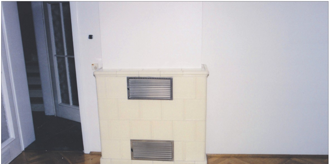
Foto des funktionsunfähigen Wärmeluftheizkörpers, der mittels der Rigipsverkleidung verdeckt wurde
